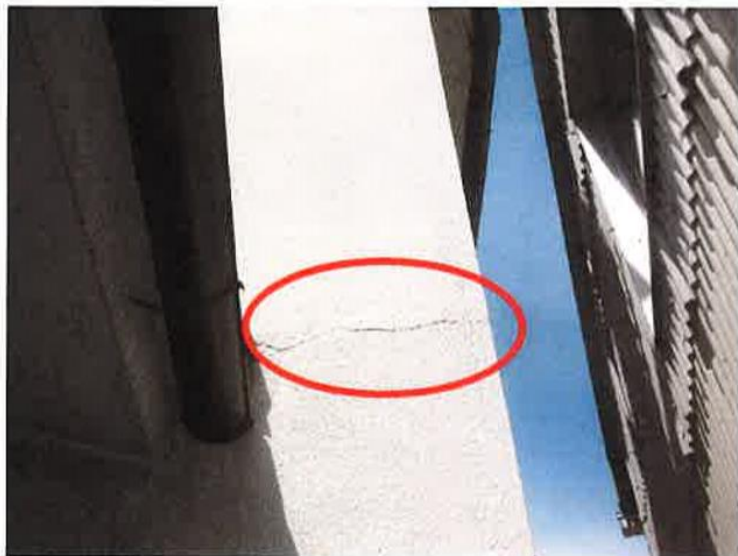
4：北側外壁部分写真 外壁の亀裂（クラック） 目視確認
