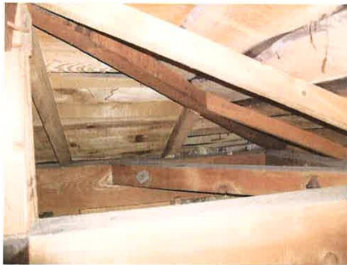
17：小屋裏部分写真 火打ち材設置 目視確認 土壁なし 目視確認
